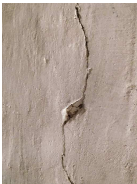
Fissure sur une maison suite à la sécheresse de 2011
